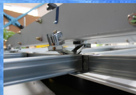
軒天井の破壊の様子
