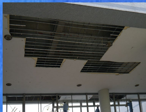
外装材被害事例
