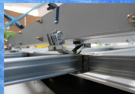
軒天井の破壊の様子
