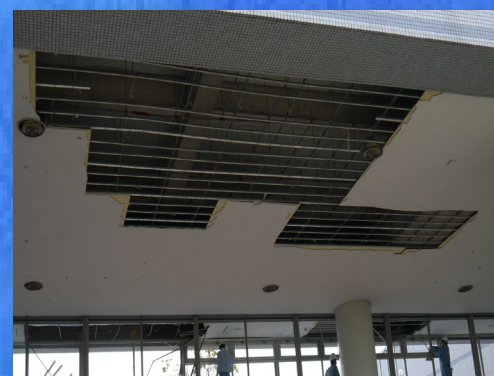
外装材被害事例
