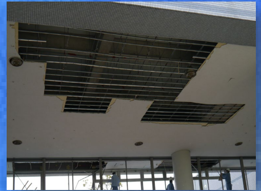
外装材被害事例
