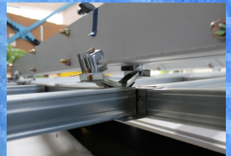
軒天井の破壊の様子
