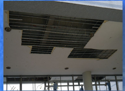
外装材被害事例
