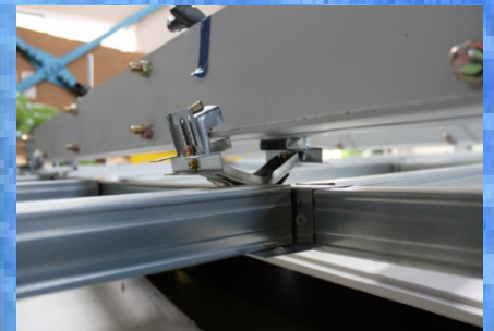
軒天井の破壊の様子
